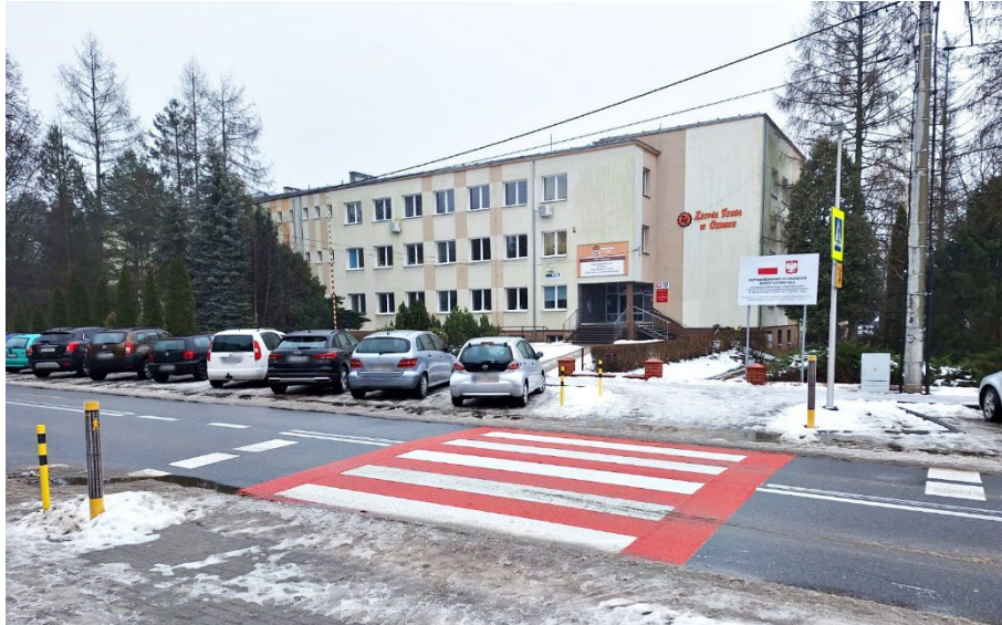
Fot. Modernizacja przejścia dla pieszych na drodze powiatowej 1771 O poprawa bezpieczeństwa na drodze do szkoły i szpitala.
